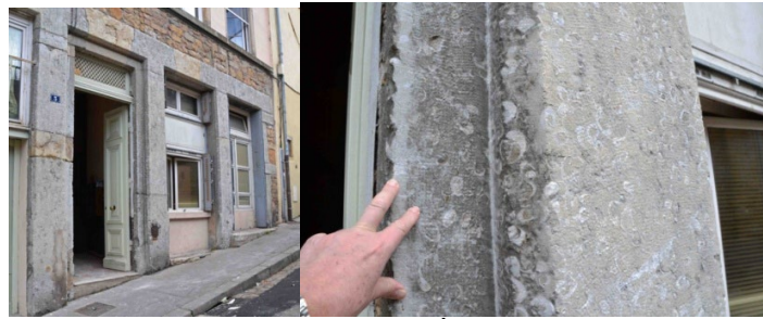
Une maison du vieux Lyon utilisant le solide Calcaire à Gryphées. À gauche : vue générale, à droite : vue rapprochée. © Pierre Thomas.
