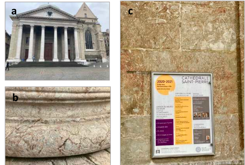
Figure 11 a) Cathédrale Saint-Pierre, façade ouest de style néoclassique. b) les six colonnes sont en Marbre de Truchefardel : pied de colonne. c) surface polie en Marbre de Truchefardel entourant la porte d'entrée de la cathédrale.
