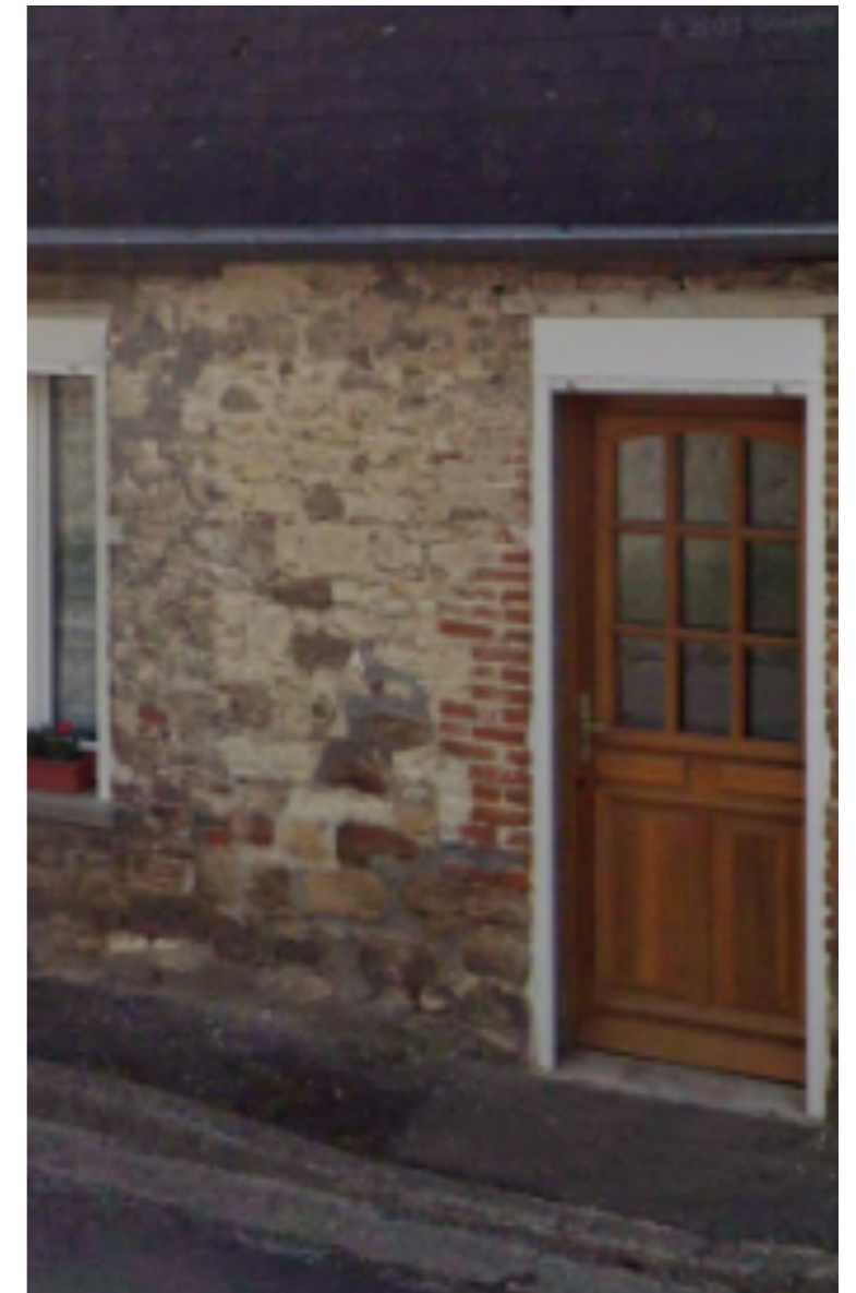
Fig. 31 : Un exemple d'intervention malheureuse d'un propriétaire qui n'a pas respecté l'état existant des murs et leur aspect original.
