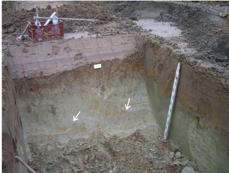
Illustration 22 - Exemple de ravines (unité 6) affectant le sommet de l'unité 5 sondage n° 108 ; Les flèches indiquent le bord des ravines
