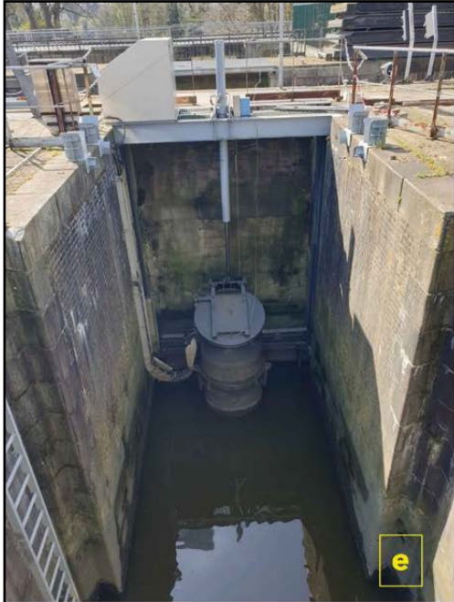
e Passage en siphon du canal des Moëres sous l'écluse du canal de Furnes, et sa pompe de relevage.
